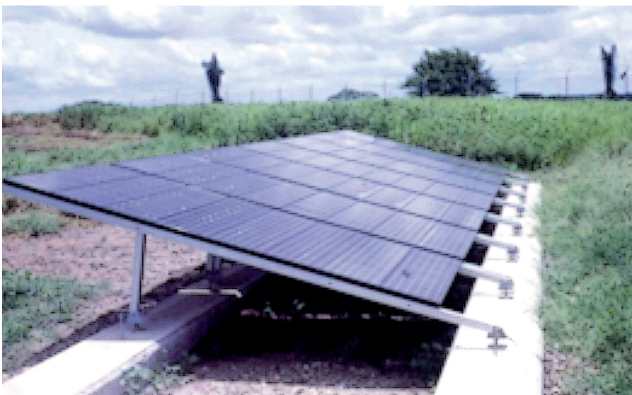
SFV del Oleoducto Caño Limón-Coveñas (5.6 kWp), años ochenta. Cortesía: Enerssin
