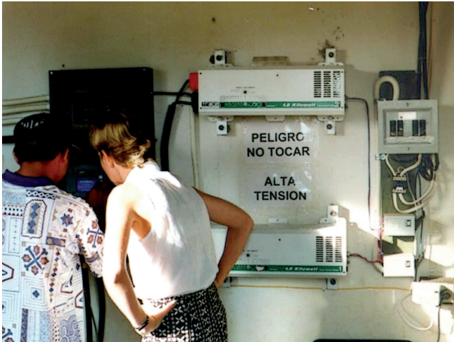
SFV 2.7 kWp La Venturosa (Vichada) (1994). Banco de inversores (La Venturosa, Vichada)
